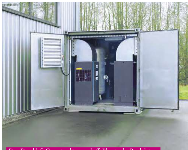
Eine Druckluft-Containerlösung schafft Platz in der Produktion.
